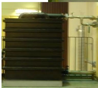
AMFI 1200 i kraftverk
